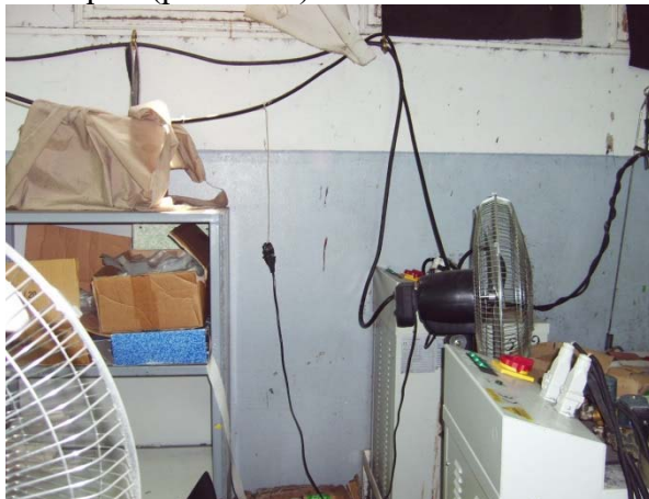
Photo 2 : Installation électrique non protégée.
